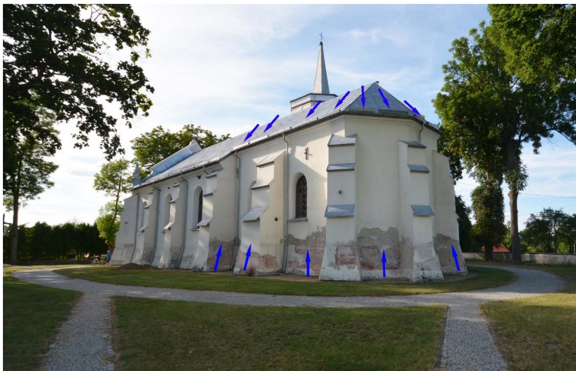
Zdjęcie nr 2. Niebieskie strzałki skierowane w dół oznaczają miejsca „przeskakiwania” wody deszczowej poza rynny spowodowane lokalizacją pełnych barier przeciwśniegowych. Woda wsiąka w grunt i następnie jest podciągana kapilarnie w murach kościoła, powodując destrukcję wtórnych tynków i substancji zabytkowej. Różowy szczelny tynk wzmacnia podciąganie wilgoci do wyższych partii muru.
