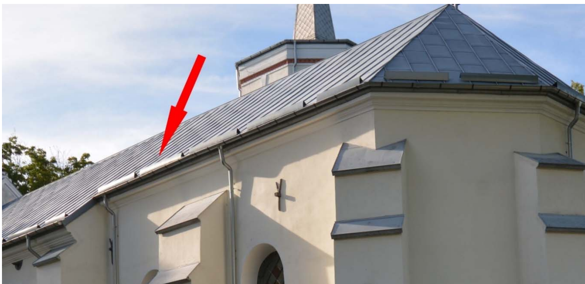
Zdjęcie nr 1. Wzdłuż okapu nawy głównej zamontowano plotki przeciwśniegowe w formie blaszanych, pełnych barier.
